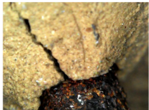
Fig. 6. Provável perda de coesão da cerâmica, ocasionada pela corrosão do elemento compositivo metálico. Autora, 2020.
