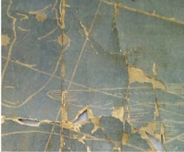
Fig. 2. Detalle de zonas con faltantes y roturas en el Mapa del cielo. Centro TAREA -UNSAM 2019.
